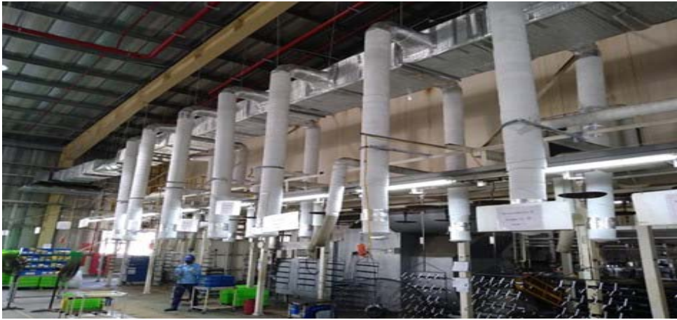
<Thiết bị bơm phun nước>
